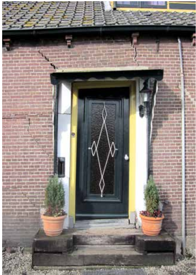
Schade door te lage grondwaterstand.
